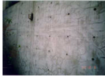
건조 수축 균열
